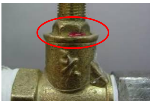
Vazamento pelo corpo do registro de pressão
