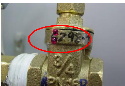
Vazamento do pelo corpo do registro de gaveta
