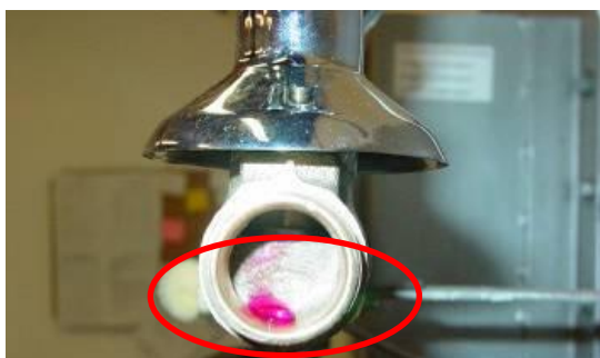
Vazamento do registro de pressão
