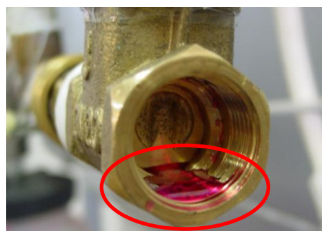
Vazamento quando o registro de gaveta está totalmente fechado
